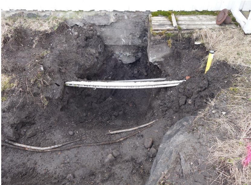
Figur 6 Inntakssted, Hovedbygningen, kulturlag påvist 2018 avdekket, sammen med nye og gamle rør og kabeltraseer.
