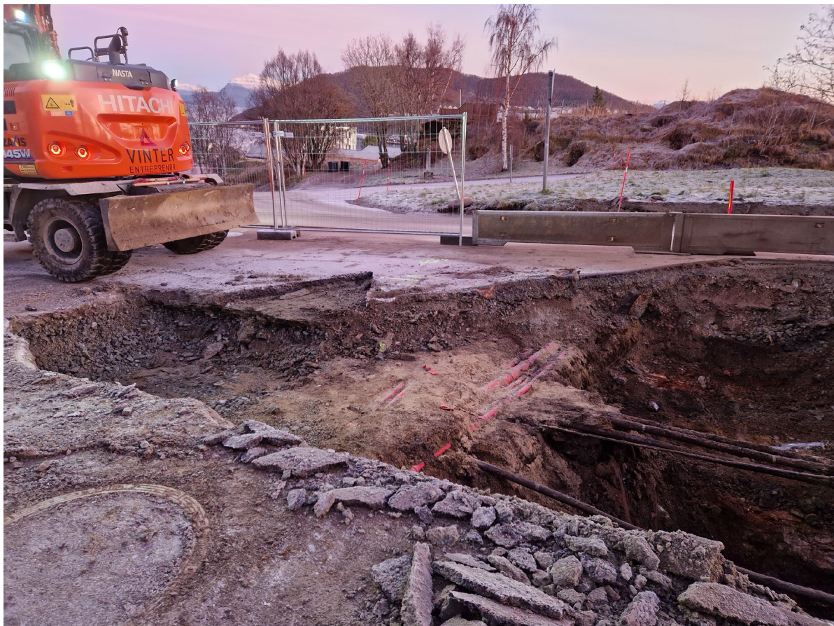
Figur 13 Inn i krysset til Erikstadgate. Alt ødelagt, men røde kabelrør (?) trolig lagt ned i 2000 (Andreassen 2000). Fast berg synlig i nedre billedkant til høyre
