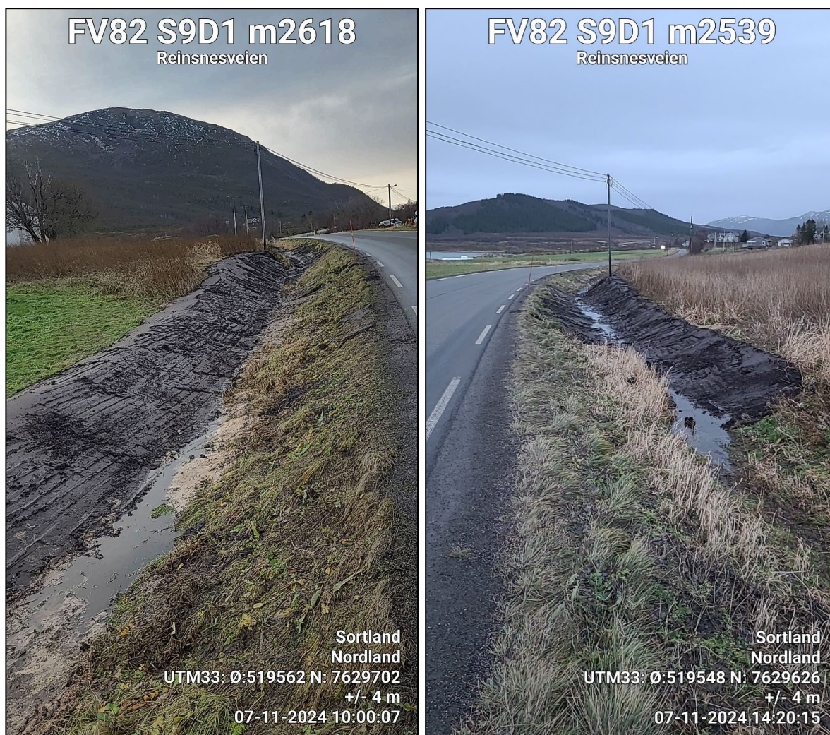
Figur 24: Foton av NFK efter att restaureringen var färdig. TV område A och B sett mot syd. TH område C och D sett mot nord.
