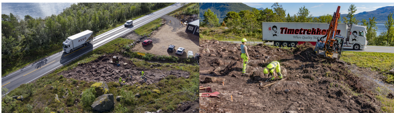
Figur 5 Forvikneset var en av lokalitetene som lå veldig nært veien, her var det 80 sone og nedsatt fartsgrense til 50 km/t. Utgjøringen sees øverst på bildet til venstre, videre mot venstre i samme bilde var en lang sving og ingen sikt.
