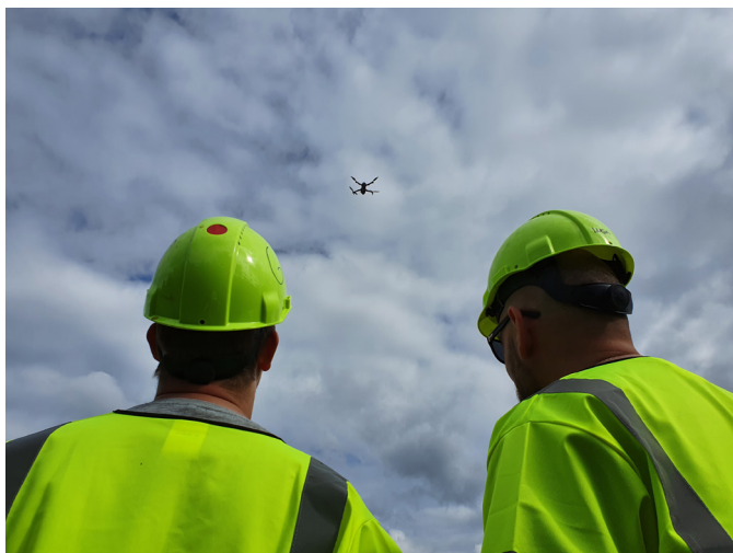
Figur 5 Erik Kjellman flyr drone på Kåringskrysset 3 og gir opplæring til Jon Gunnar Blom
