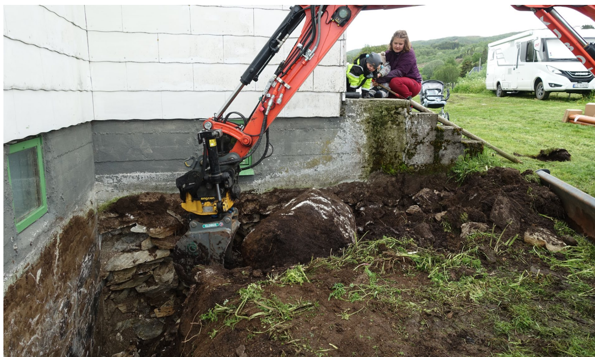
Figur 3: Fjerning av store steiner i det nordvestlige hjørnet. Nøye observert av familien i huset.
